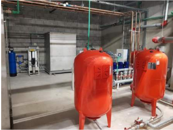
Εγκατάσταση αντίστροφης ώσμωσης νερού
