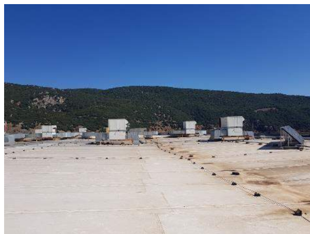
Ψυκτικοί πύργοι δώματος ορόφου
