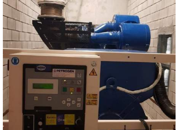
Η/Ζ (γεννήτρια) 900 kVA
