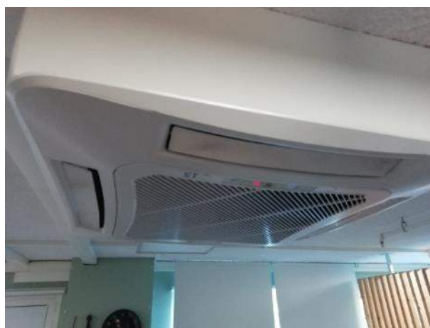
Fan coil οροφής IKEA
