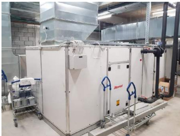
Μονάδα διαχείρισης αέρα (Air Handling Unit)
