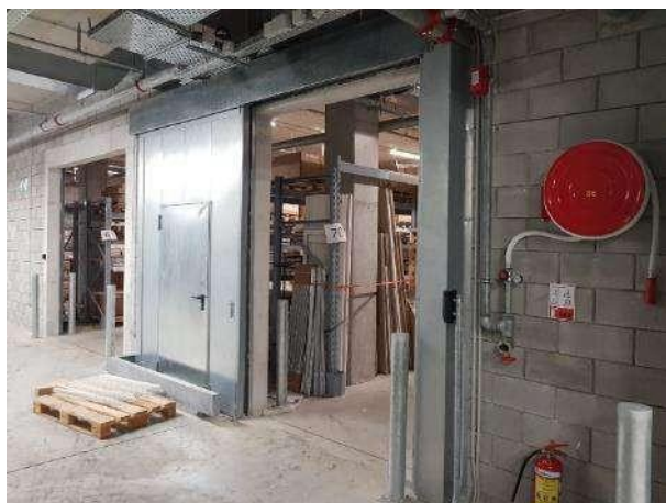
Αυτόματη θύρα πυροπροστασίας
