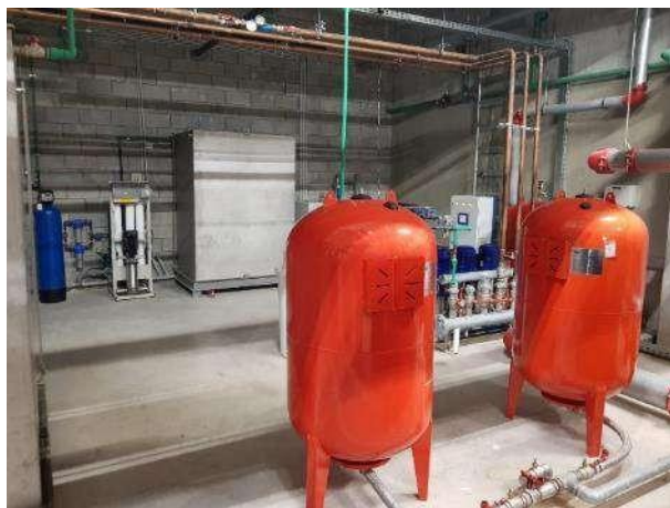
Εγκατάσταση αντίστροφης ώσμωσης νερού
