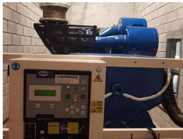
Η/Ζ (γεννήτρια) 900 kVA
