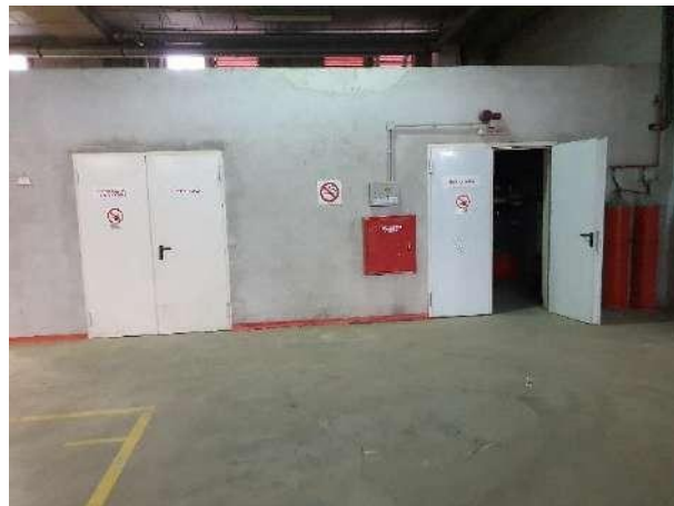
Χώρος Η/Μ κτίριο Α
