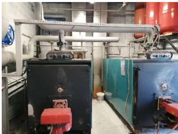
Η/Μ IKEA (λεβητοστάσιο)
