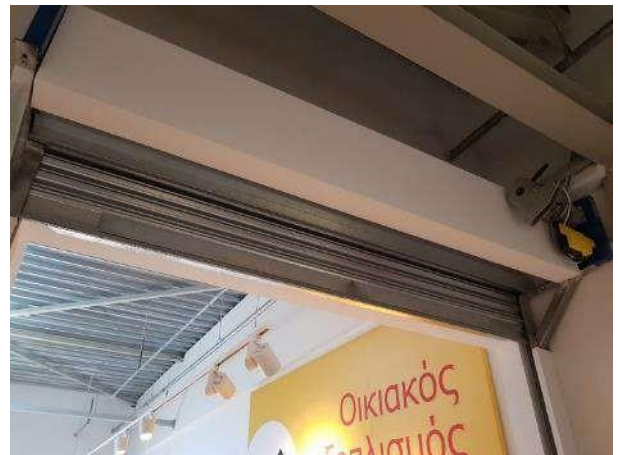
Αυτόματο ρολό πυρασφαλείας (αίθριο κλιμακοστασίου)
