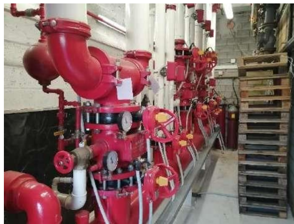
Η/Μ IKEA (sprinkler room)
