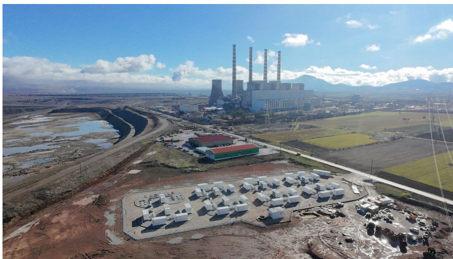
Εικόνα 4: Συστοιχία συσσωρευτών του Σταθμού Ηλεκτροχημικής Αποθήκευσης Πτολεμαΐδας IV. Διακρίνεται ο ΑΗΣ Καρδιάς, αλλά και η θέση του κάτω ταμιευτήρα του μελλοντικού σταθμού αντλησιοταμίευσης.
