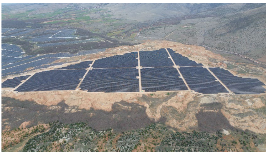
Εικόνα 2: Τμήμα φωτοβολταϊκού σταθμού ισχύος 171 MW σε περιοχή αποθέσεων του Λιγνιτικού Κέντρου Δυτικής Μακεδονίας.
